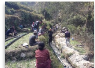
Des tuyaux pour l'eau potable
