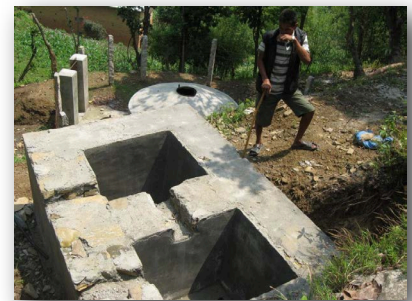
Réservoirs de stockage d'eau
