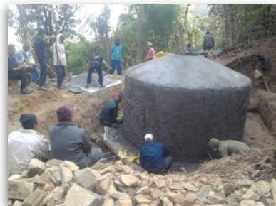
Reservoir d'eau potable
