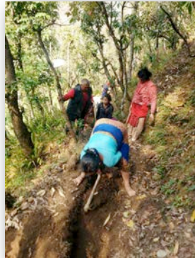
On creuse la tranchée pour le pipeline au pic et à la pelle!
